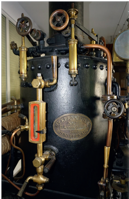
Dampfkessel mit Wasserstandrohr, Überdruckventile, Bläserventil und Dampfstrahl-Injektor-Ventil
