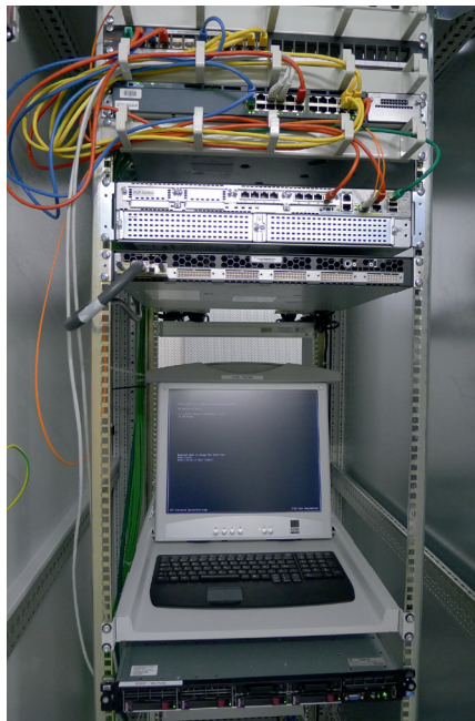
Kontroll- und Steuerstation des digitalen Alarmierungsnetzes
